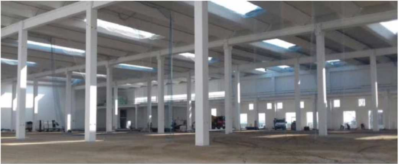
Il nuovo centro logistico in fase di costruzione in via Conche, alla periferia di Isola Rizza
